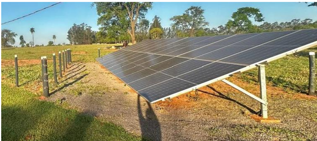
PLACAS DE ENERGIA SOLAR
